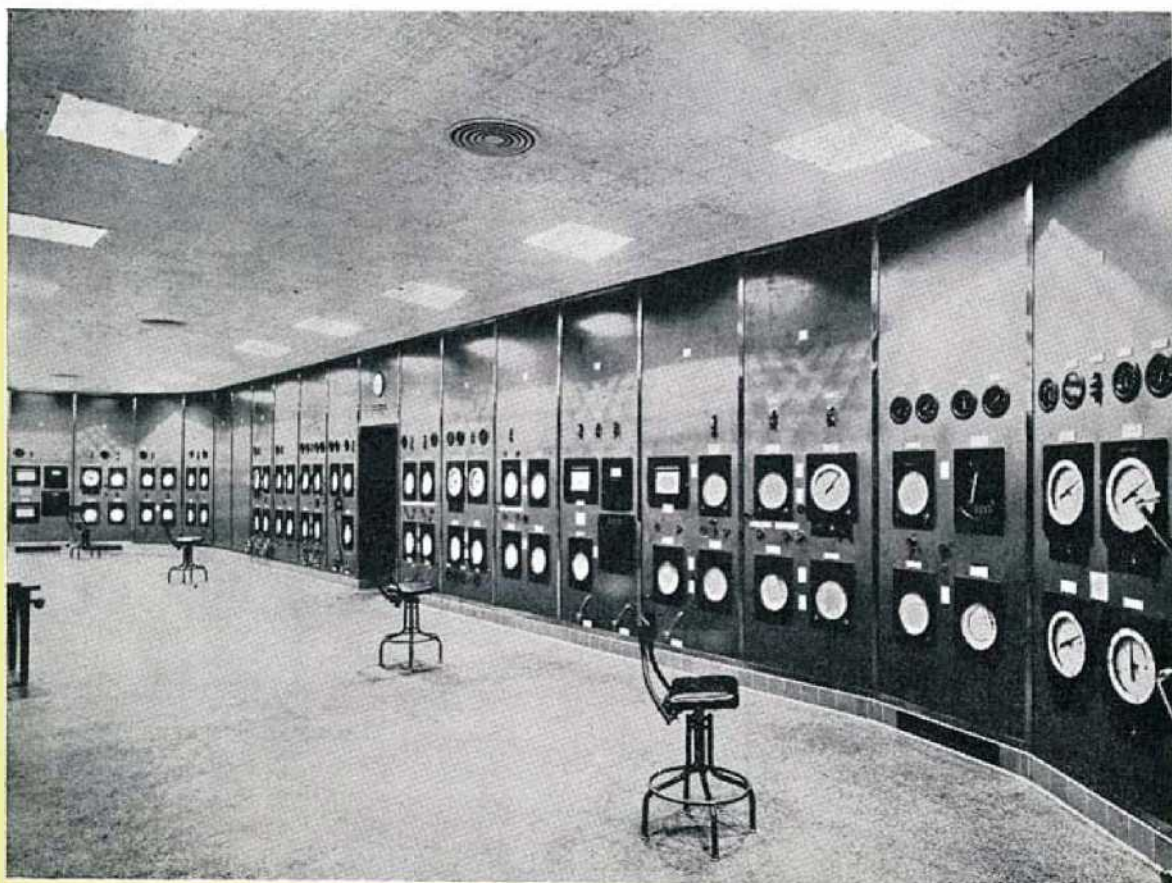
POSTE CENTRAL DE CONTROLE ET DE REGLAGE DANS UNE GRANDE RAFFINERIE DE PETROLE
